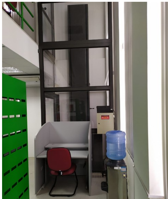
Foto 2: Plataforma elevatória – Biblioteca
