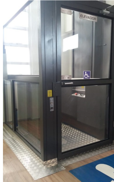
Foto 2: Plataforma elevatória – Biblioteca
