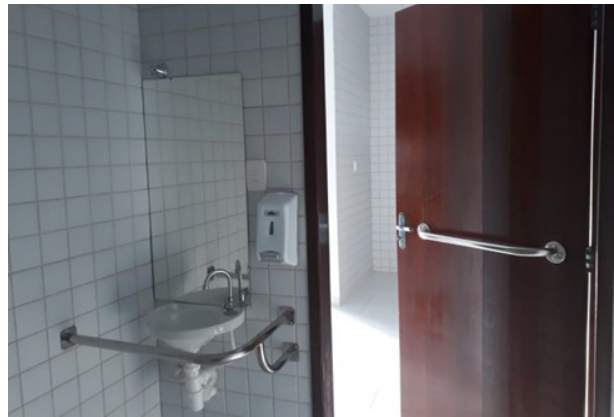
Foto 9: Barras de apoio na porta e próximo ao lavatório
