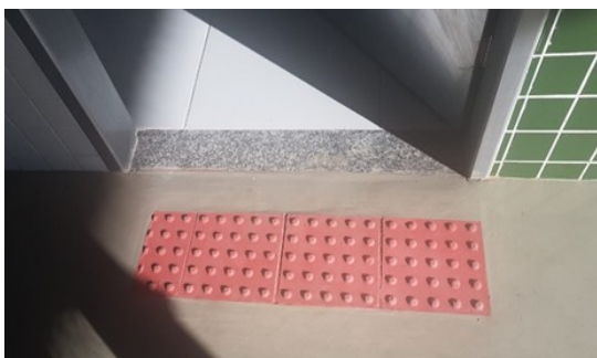
Foto 6: Piso podotátil de alerta
