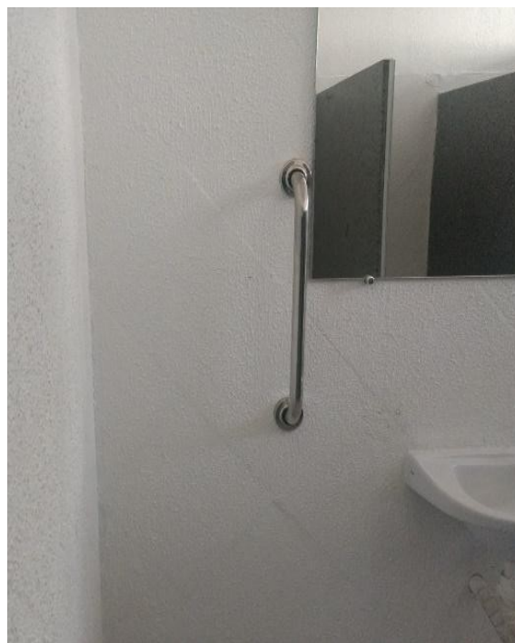
Foto 2: Barra de apoio ao lado dos lavatórios em cada banheiro acessível de cada pavimento
