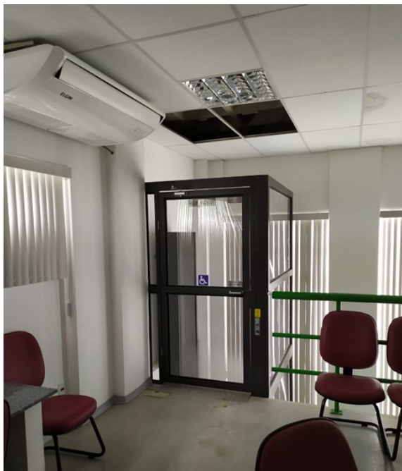
Foto 1: Plataforma elevatória – Biblioteca
