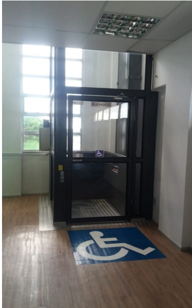
Foto 1: Plataforma elevatória – Biblioteca
