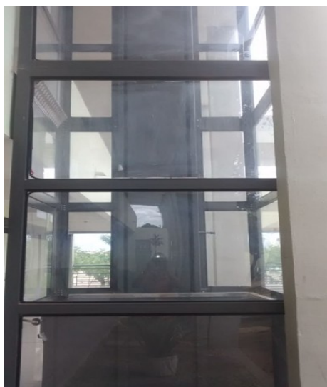
Foto 13: Plataforma elevatória – Bloco de Eletrotécnica
