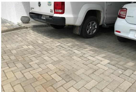
Foto 3: Piso intertravado irregular – antes
