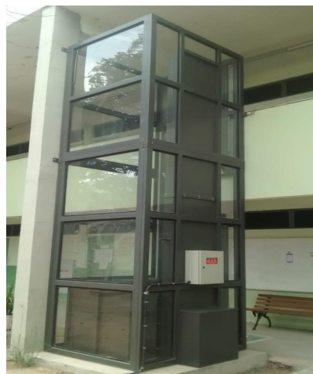
Foto 14: Plataforma elevatória – Blocos de Física/Alimentos/Laboratórios
