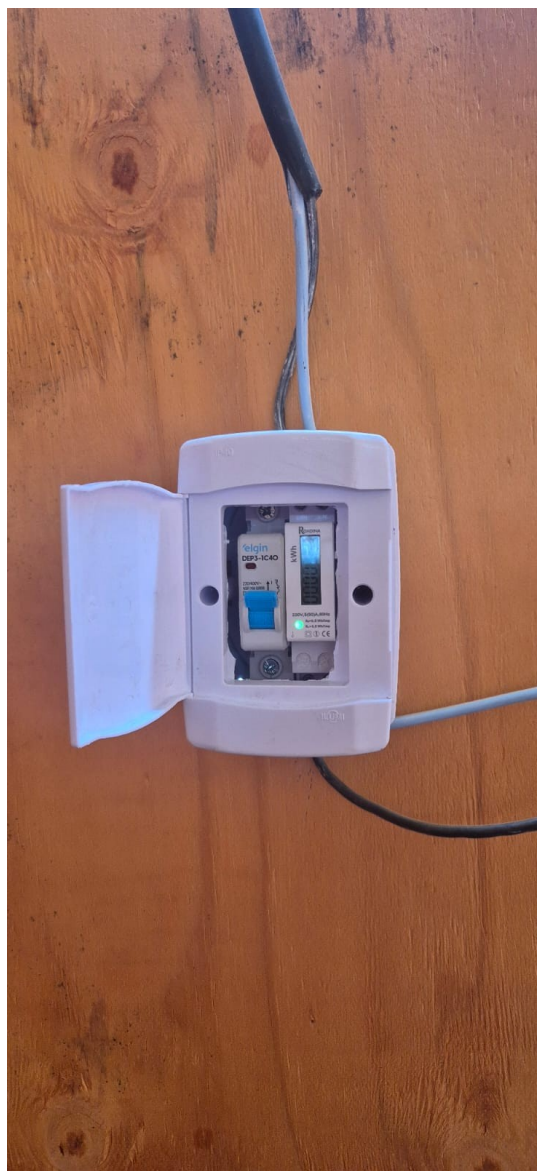
Figura 10. Ligação provisória de energia
