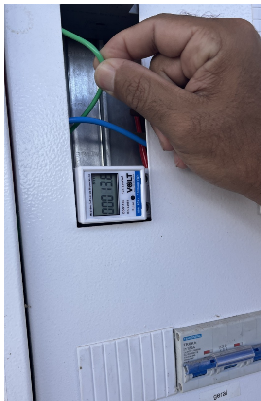
Figura 4. Ligação provisória de energia
