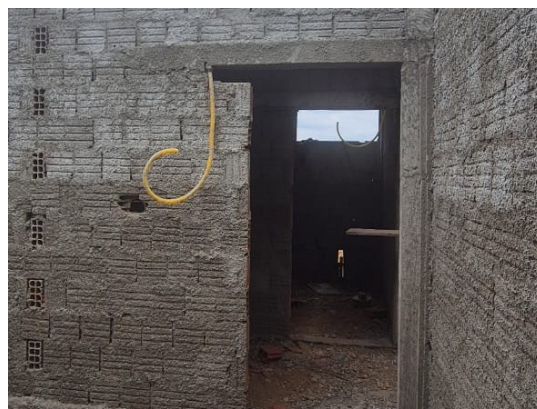
Figura 10. Verga de vão de porta.
