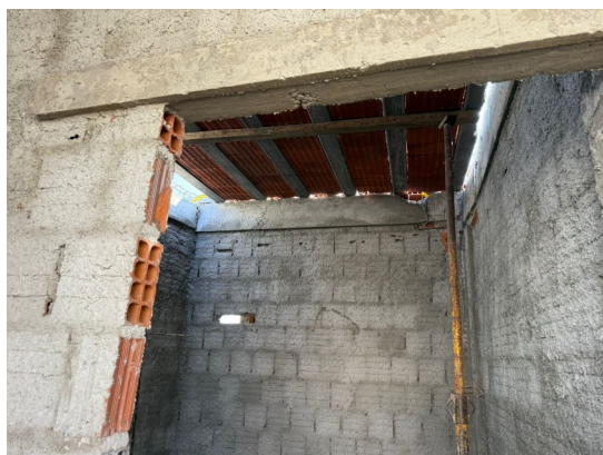
Figura 9. Verga de vão de porta.
